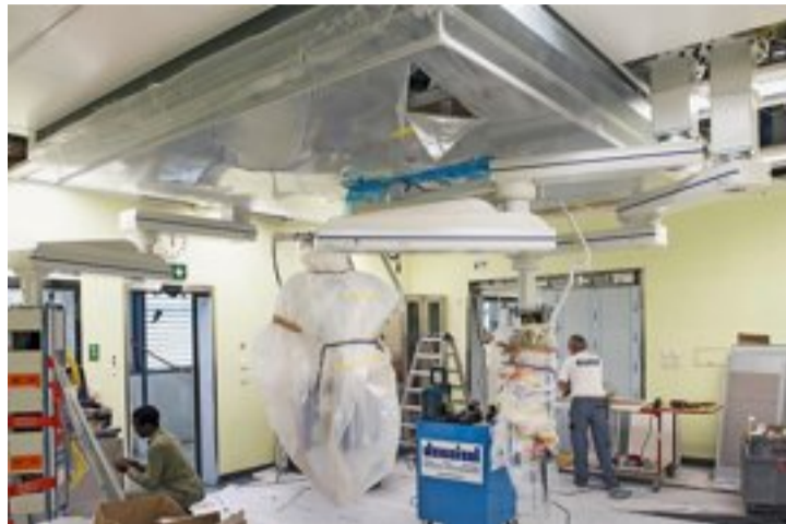
Bis zum Frühjahr erhält das Inselspital drei neue Operationssäle, die mit sämtlichen bildgebenden Geräten ausgerüstet werden. Bilder Stefan Anderegg
